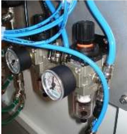
Servitudes de gaz : Azote et Air comprimé
